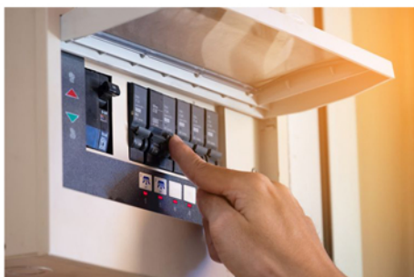
rozvodná elektrická skriňa
